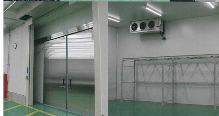
上 / 冷蔵庫内のトラックヤード 下左 / 冷蔵庫入口 下右 / 冷蔵庫内部
